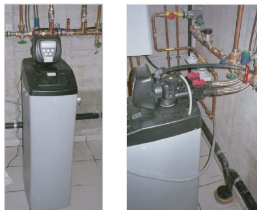
Installation d'un adoucisseur volumétrique
